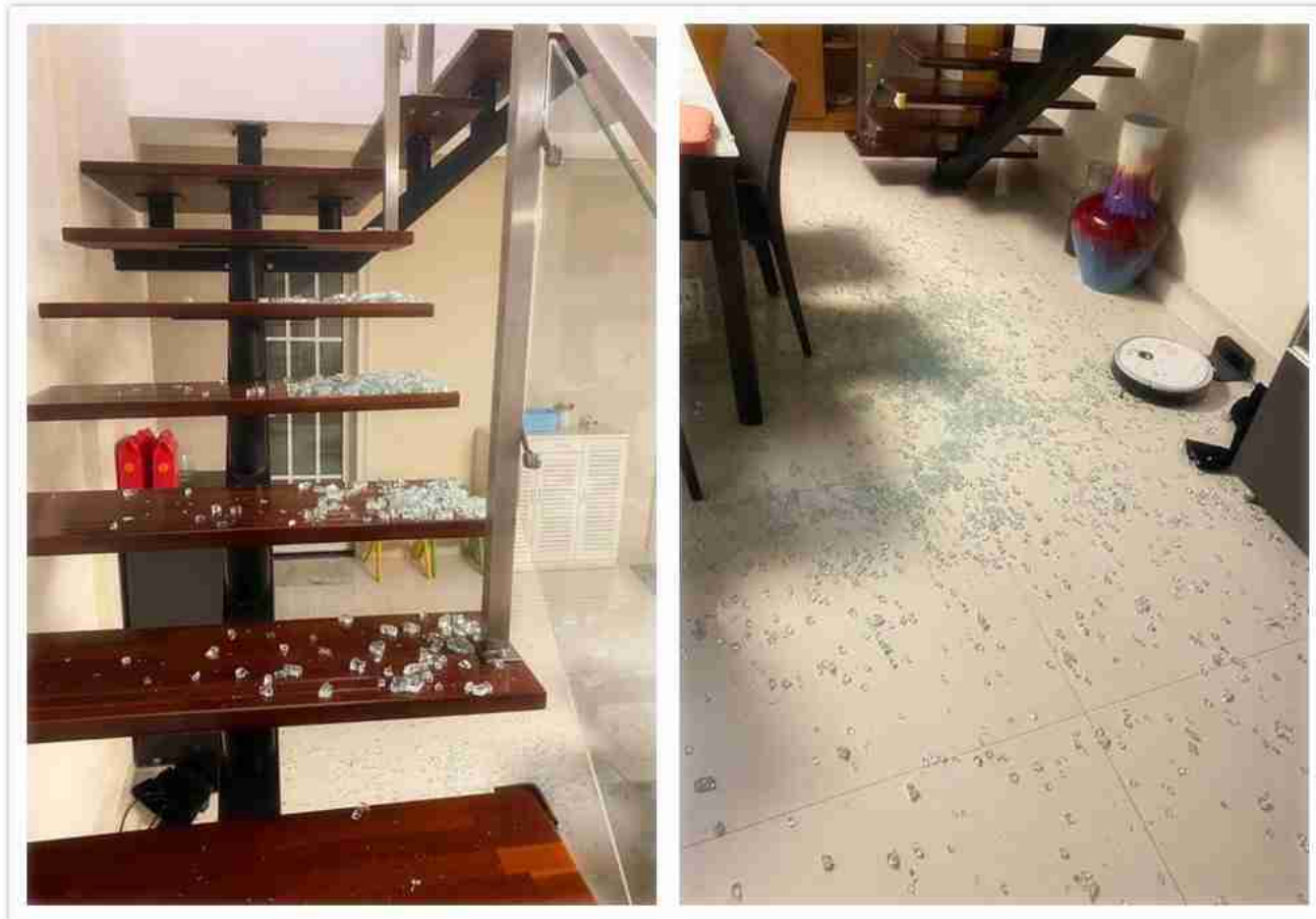
Escadaria grade de vidro temperado quebra espontânea
