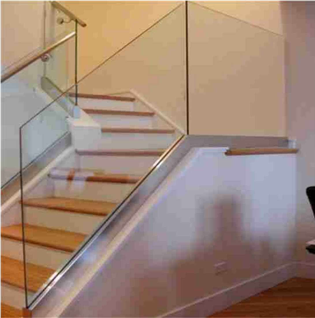
Garde-corps sans cadre de canal de U pour l'escalier
